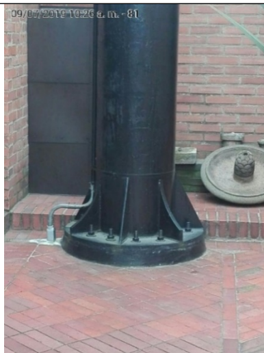
Foto No.2: Detalle de la base de la estructura de la valla ubicada en la Calle 127 No. 70G-69 (dirección catastral), orientación Este-Oeste
